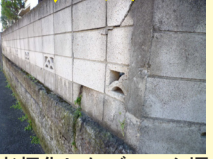
老朽化したブロック塀
