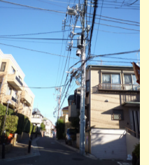
重いトランスの乗った電柱
